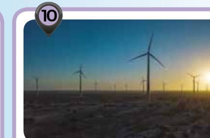
Projeto Eólico Acauã Participação acionária: 100% Potência instalada: 109,20 MW Garantia física: 57,77 MW médio
