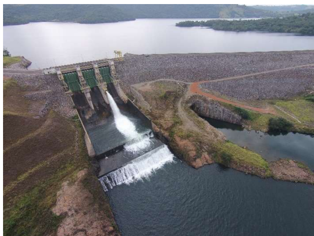
Figura 02 – Vista da barragem e vertedouro com válvula dispersora acoplada na estrutura do vertedouro.
